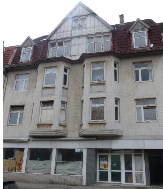
Abbildung 36: Beispiel für ein Gebäude mit hohem Modernisierungs- und Instandsetzungsbedarf
